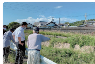
豪雨で被害を受けた現場視察
