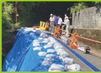
豪雨で被害を受けた道路を調査
